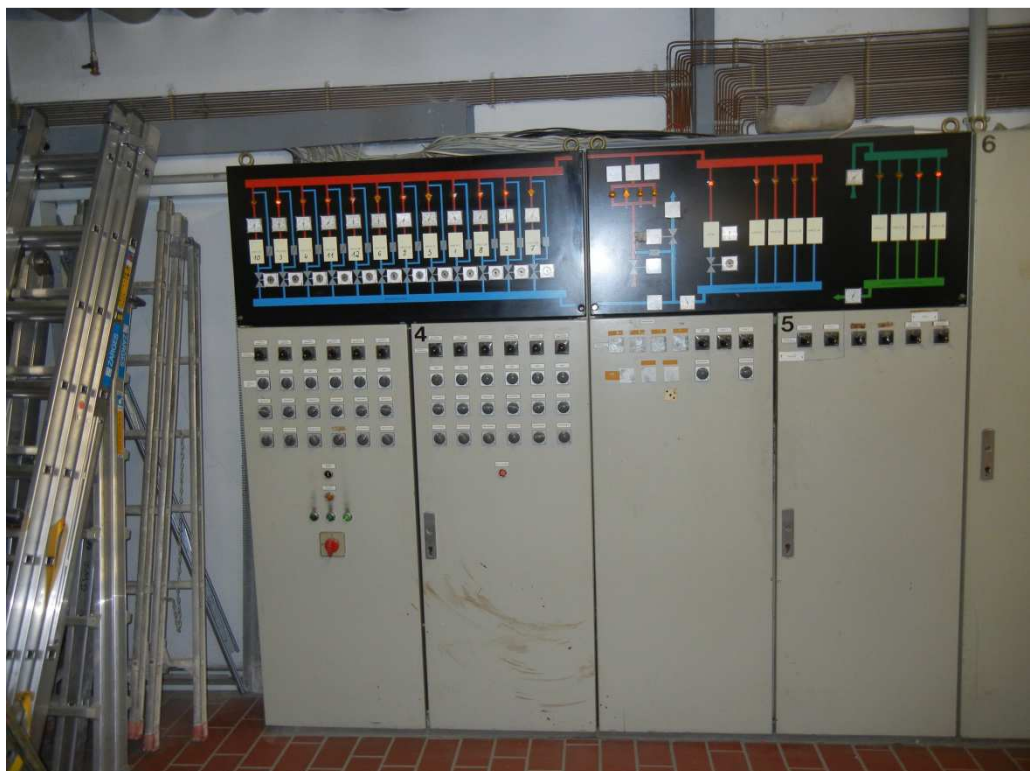
Abb. 21 Pneumatische Regelungstechnik (Gebäude GW2)
