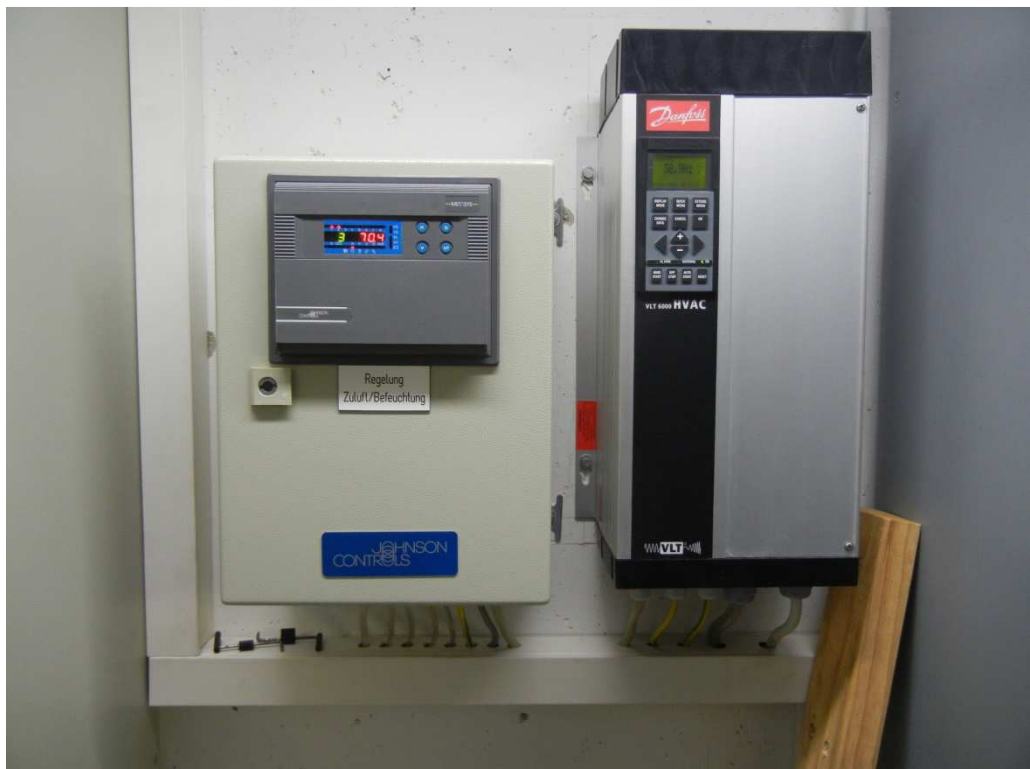
Abb. 24 Frequenzumrichter in der Lüftungsanlage in Gebäude NW1 (IMSAS)
