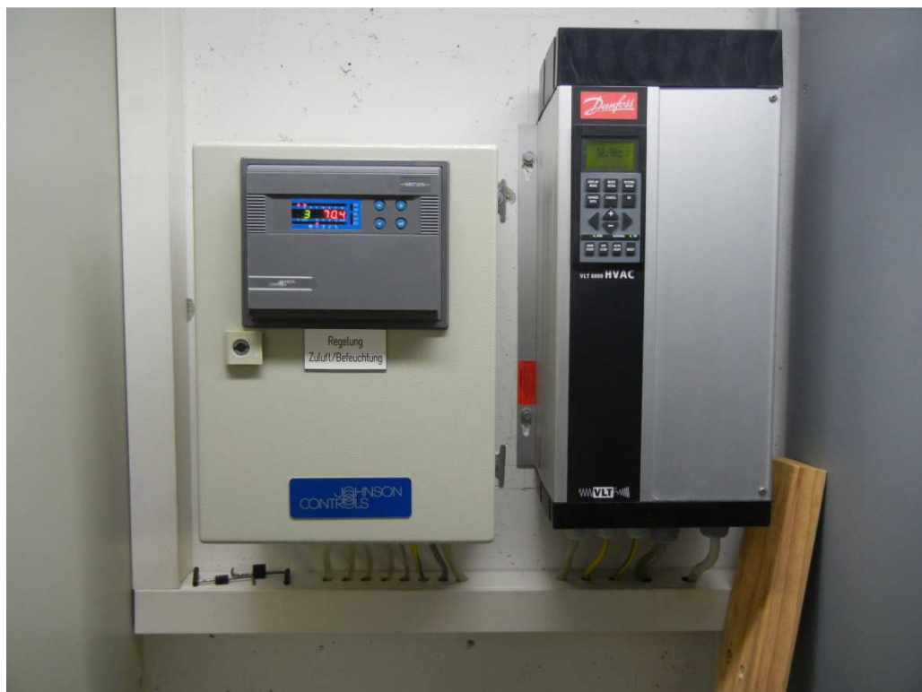
Abb. 26 Frequenzumrichter in der Lüftungsanlage in Gebäude NW1 (IMSAS)
