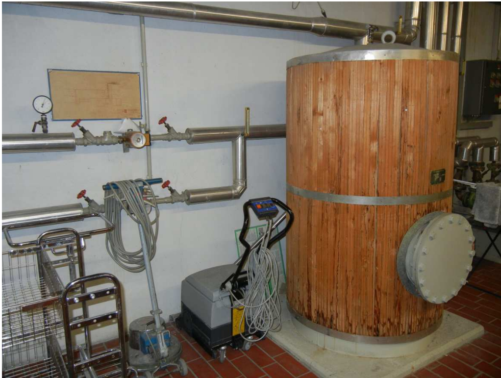
Abb. 22 Wärmetauscher zur Warmwassererzeugung (Gebäude GW2)
