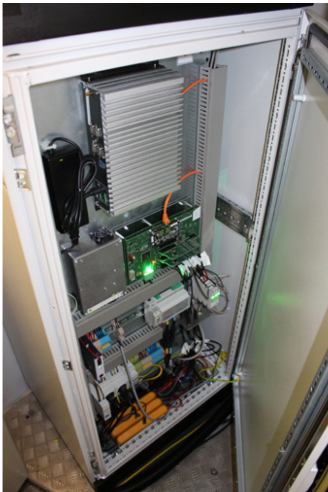
Abb. 2: Messsystem zur Aufzeichnung in einer WEA
