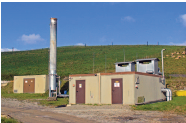
Verarbeitung: Deponie Gasverdichterstation
