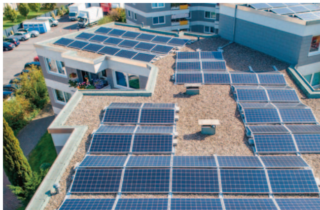
Fotovoltaikanlage auf Wohnbebauung
