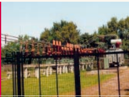
Abb. 10: Übergabestelle für elektrische Energie bei der Energiezentrale
